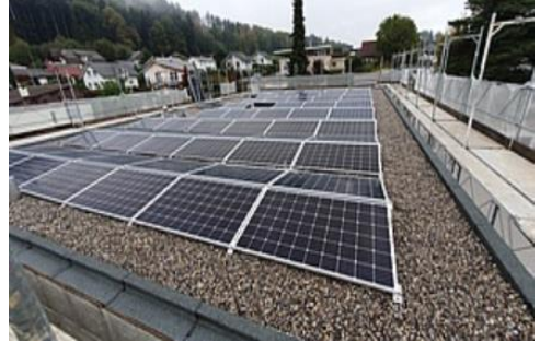
PVA Primarschulhaus II Orpund, Dach Nord
